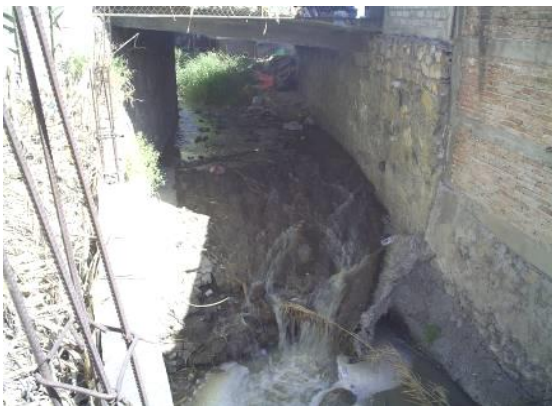
Cruce con vialidad de la barranca San Miguelito, obsérvese la gran cantidad de escurrimientos
