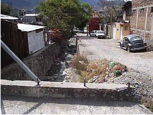
Barranca Pezuapa, (Principal) aguas arriba del libramiento, obsérvese asentamientos sobre la barranca
